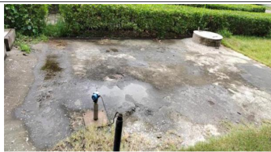
中水处理（均质池）
