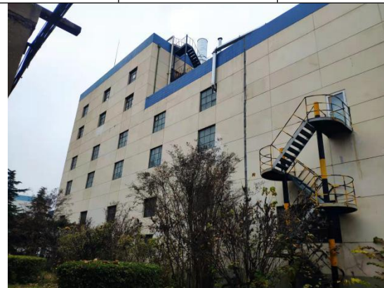
医疗基材车间顶部 RTO 装置
