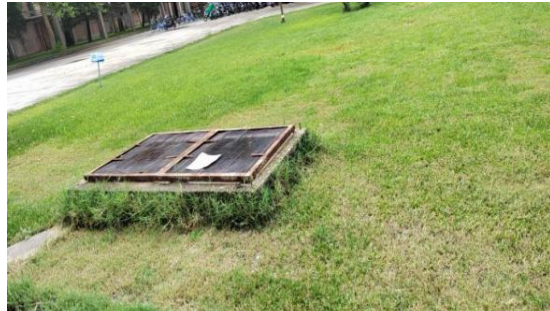
含银废水处理（均质池）
